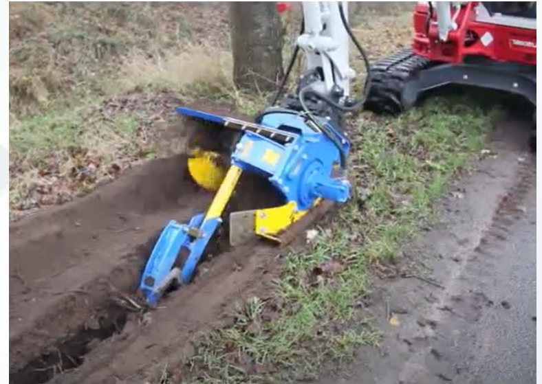
Sleuvenfrees (2km/u) vraagt zorgvuldige planning om tot veilige afstand van kruisende leidingen te frezen
