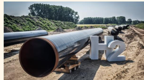
Een waterstofleiding van Fluxys. Dankzij Geo Square kan de gasnetbeheerder weten waar al zijn leidingen liggen. ©Tim Dirven
